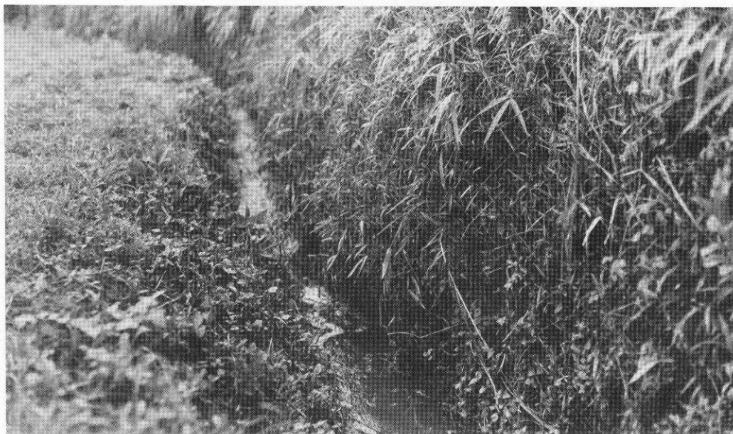
図版11 土堤の斜面が肩より約60cmほどずり落ち用水路をせばめた。
