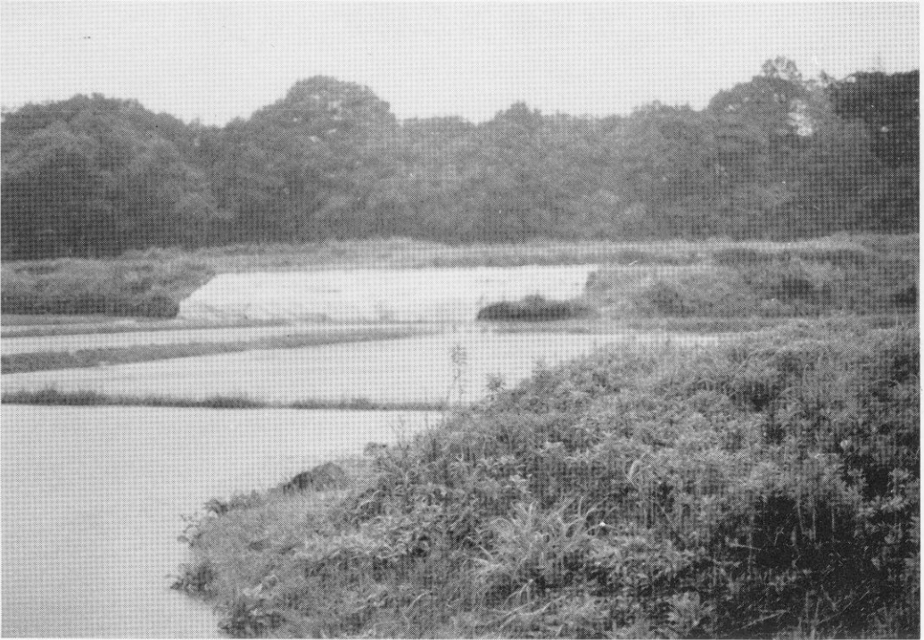
図版12 崩壊箇所の応急防災処置(太宰府町社会教育課職員による)
