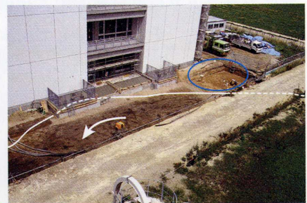
▲創成科学研究棟南で検出された埋没河川 白線は埋没河川の範囲、青線は続縄文文化の活動場所のひろがりを示しています。この河川は続縄文期には河川として機能していましたが、次の擦文期になると埋積してしまったことが判明しています。
