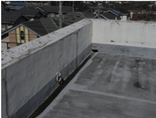
屋上 排水溝隅部から雨樋に雨水が落ちる
