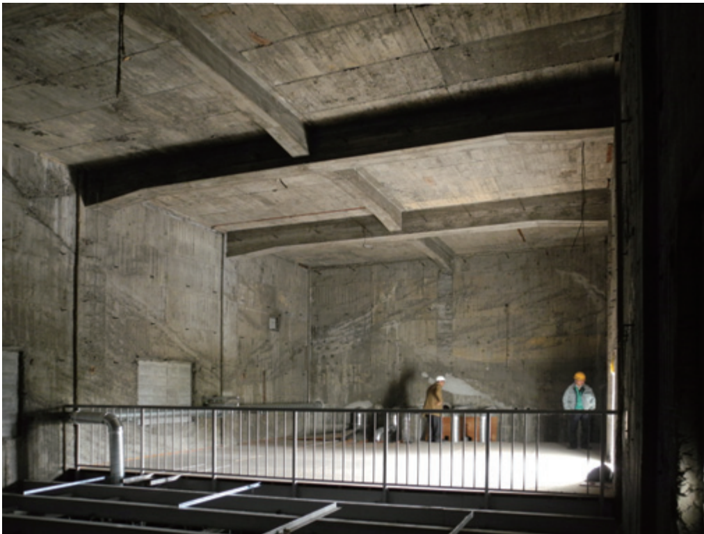
室内 北西を見る。2階は建設当初の姿で残る。壁は柱真より内側に設けられており、柱が壁面から突出しない。
