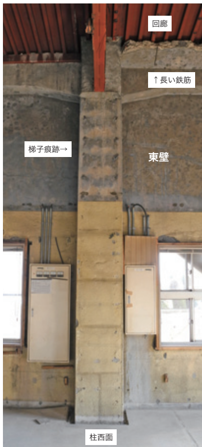
柏市による3Dレーザー測量実施のために天井を解体、回廊と梯子の痕跡が明らかになる。 梯子の取り付け柱西面。梯子は幅約470ミリで、高さ方向に300ミリの間隔で取り付けられていたことが読みとれる。
