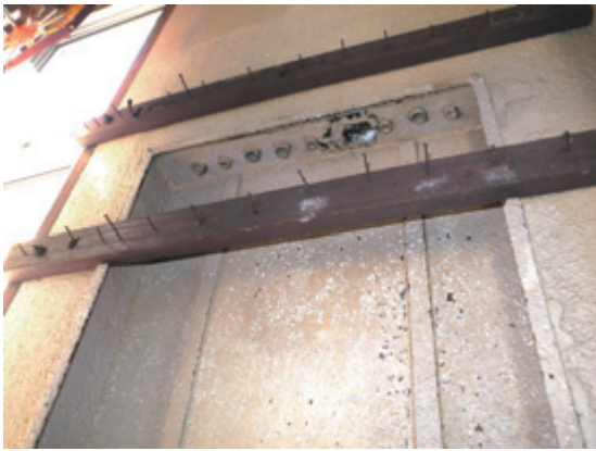
1 階西壁 スイッチボード内部見上げ 配線の本数は、防空学校の調光操作盤結線図と一致する ※
