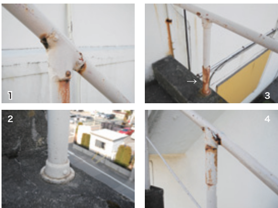
手摺り詳細 1/ 手摺り・手摺り子接続部 2/ 手摺り子座金 3,4/ 手摺り子に太い管を繋げて使用
