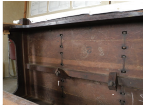
厚板間はボルトで継がれる。切断された斜材端部が残る
