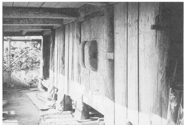
第16図 沖縄県具志川村の倉庫扉
