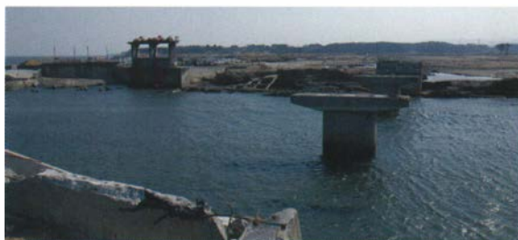
写真2 東日本大震災被災状況(2) (原町区小浜付近)
