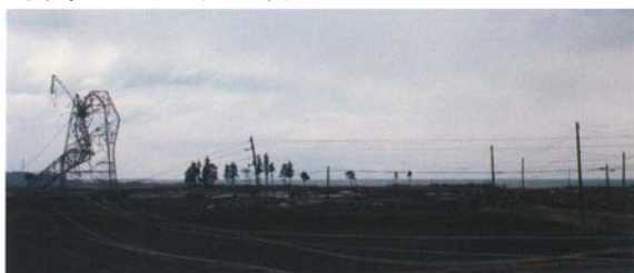
写真3 東日本大震災被災状況(3) (原町区栗付近)
