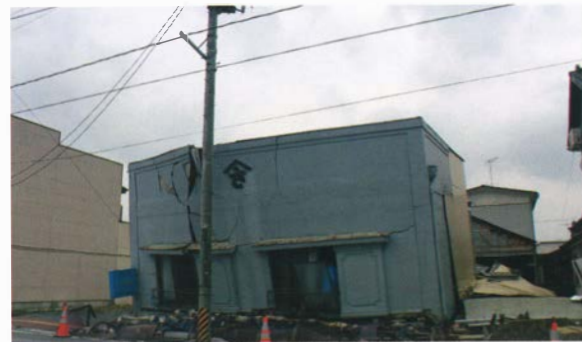
写真12 東日本大震災被害状況(12)
