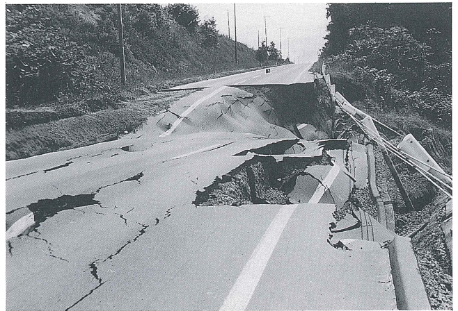
第19図 道路の損壊（字八束）
