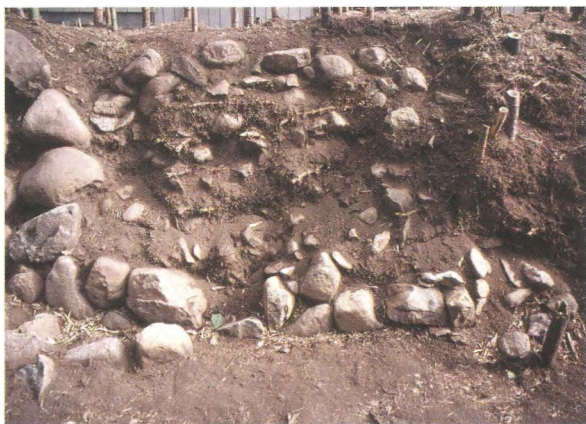
3 石垣崩落状況
