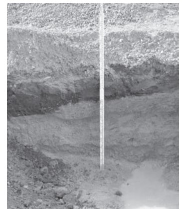
浸透槽設置箇所堆積状況
