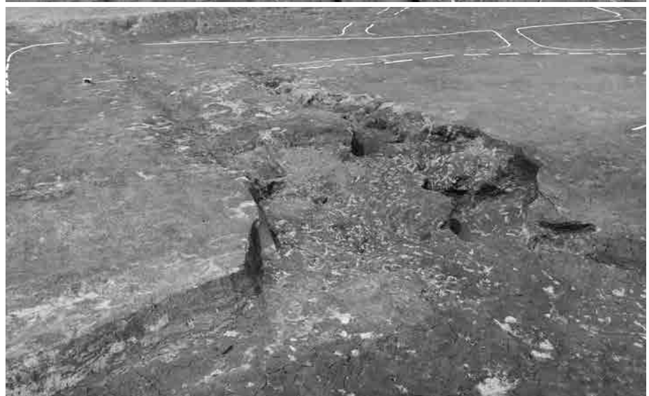
3. 04081 破堤 (南西から)
