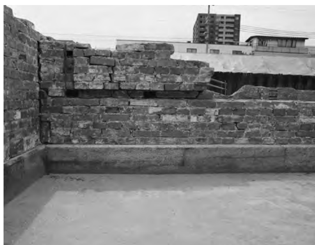
4. 43区画 西辺間仕切り壁の煉瓦の抜け (東から)
