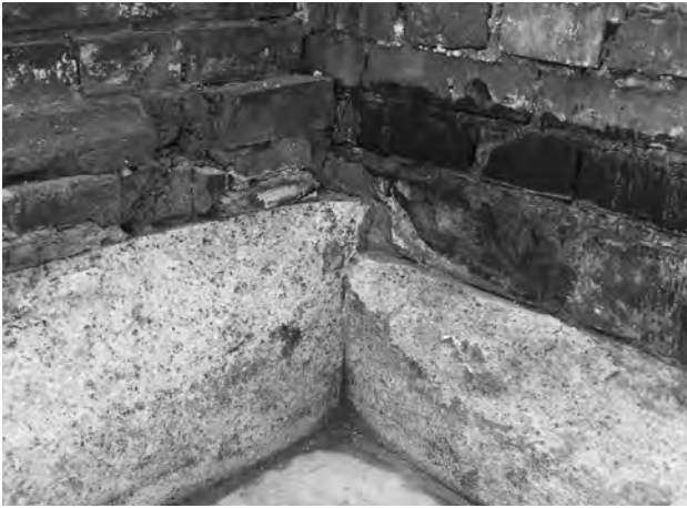
3. 9区画 南東柱西辺(左)と外周壁南辺内面(右) 幅木使用石材の高さの違い (北東から)
