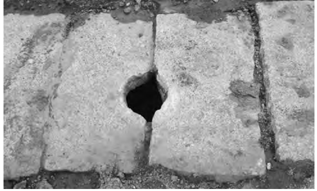
2. 62 土管接続部の 68 石組溝蓋石の穿孔 (北から)
