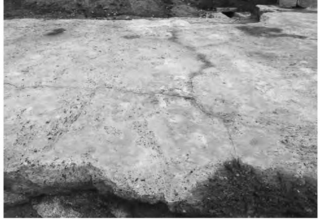
2. 22 玄関 基礎上北側モルタル痕跡 (西から)
