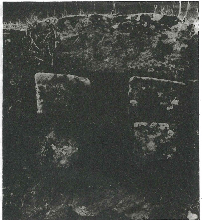
图版 25 家庭污水排水沟(上)(下)
