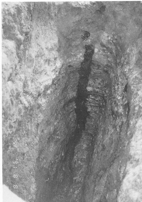
TP 6の地割れ (NE-SW)
