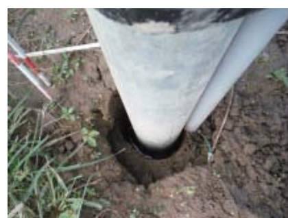
参考 強風後の鋼管柱根元 (西任田遺跡8区)
