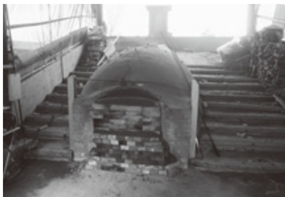
写真4 閉塞状況（焚口側）
