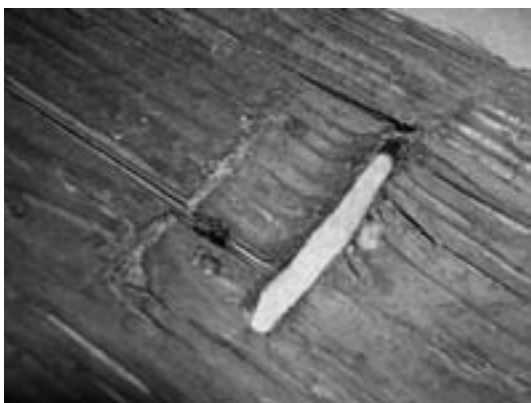
写真9 集弦孔と別部材装着箇所
