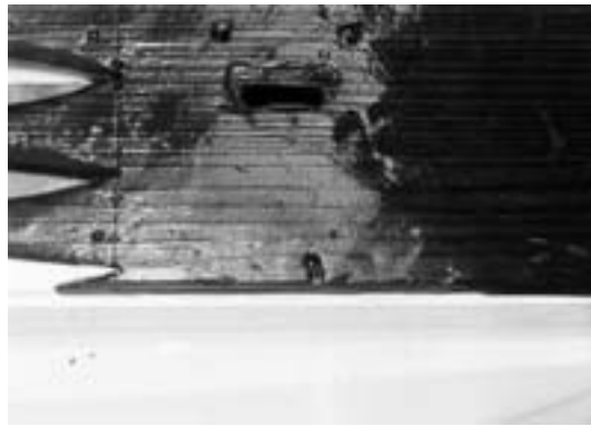
写真6 琴尾側の補修孔と方形孔
