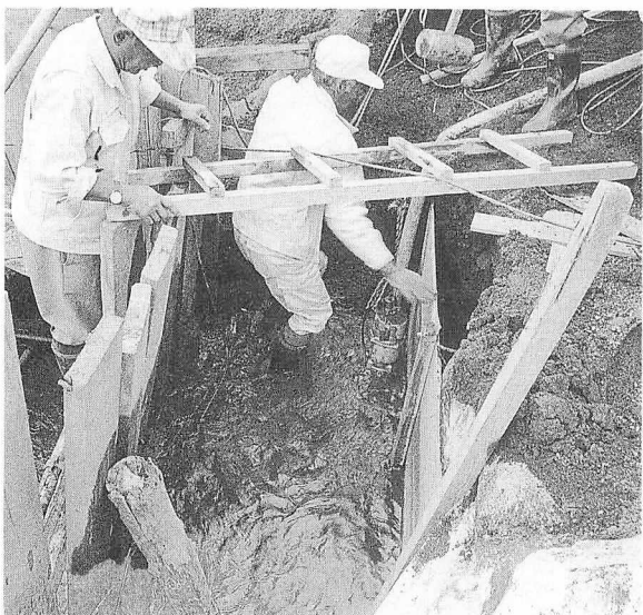
5 6インチポンプ釜場裏出水状況 (E→W)
