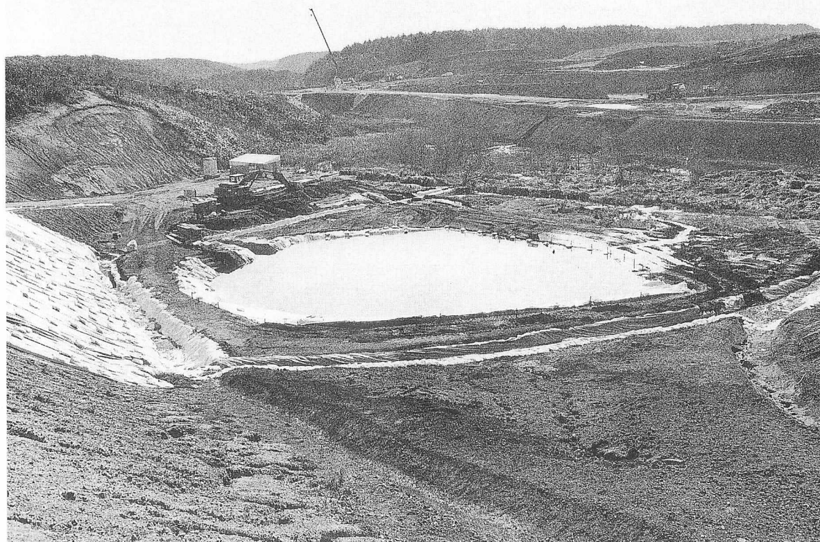
5 越年作業終了後の冠水状況 (N→S)
