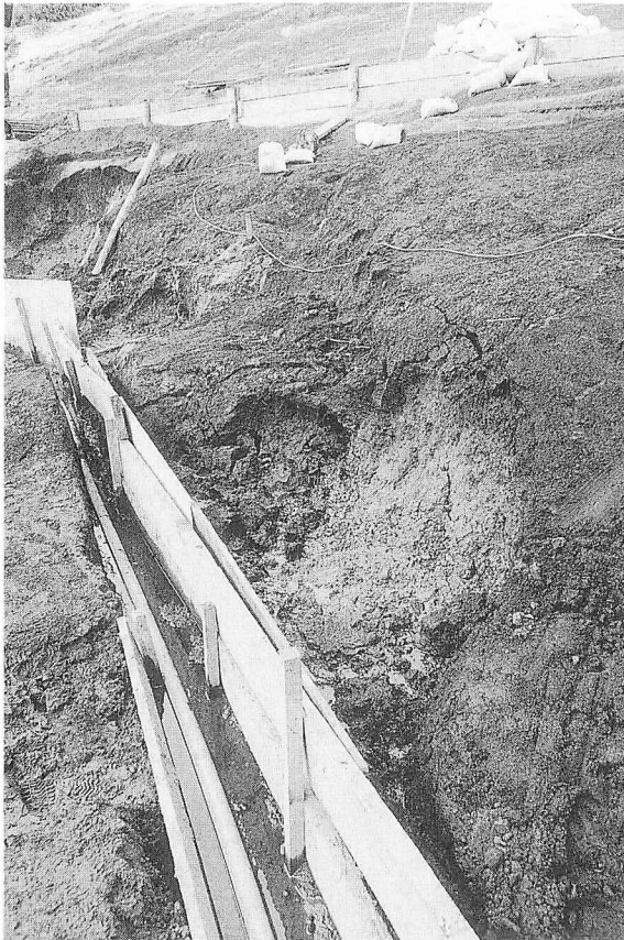
4 排水溝と土砂崩落状況 (E→W)
