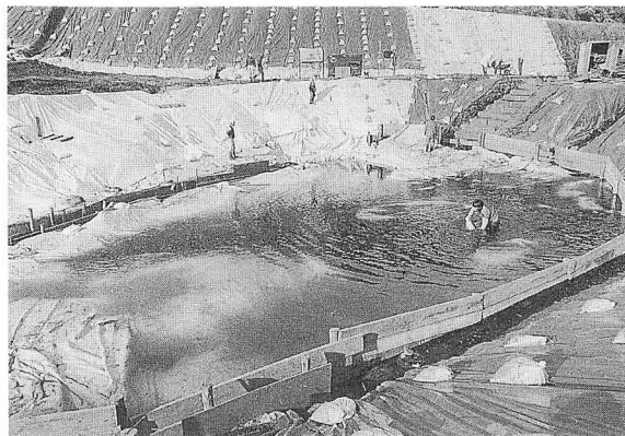
4 ポンプ撤去後の出水状況 (S→N)
