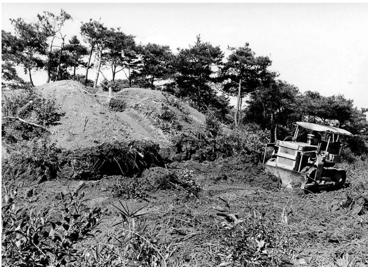
2 1号墳周辺の削平状況（南から）
