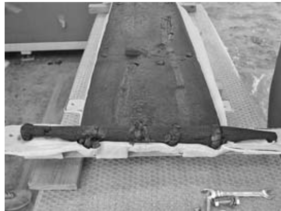
写真6 板材(第2図1)裏面上部
