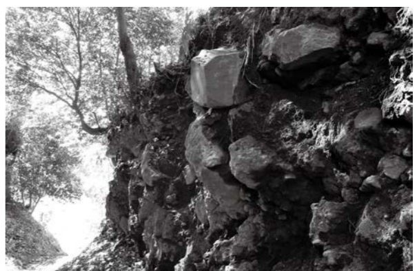
写真 52 大空堀 岩盤露出状況 (TRE5 付近)
