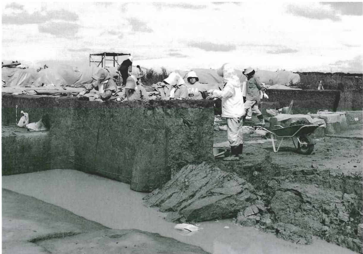
降雨後ベルト崩壊状況 (69-161) S→N
