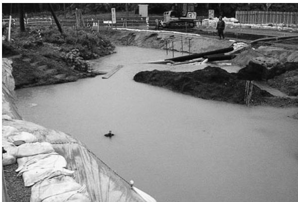
7. 大雨による水害状況(南から)
