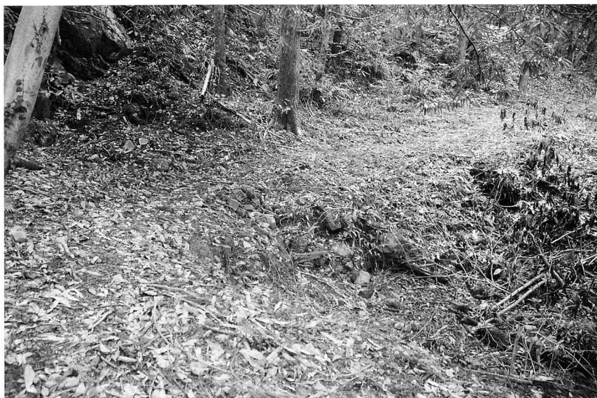
旧街道崩壊箇所
