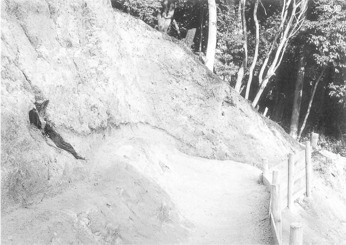
(1) 土砂堆積状況(南西から)
