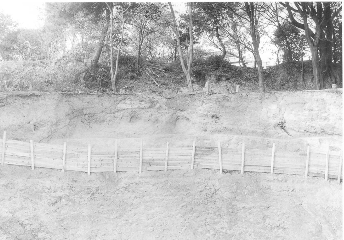
(2) 土塁崩落箇所壁面(南東から)
