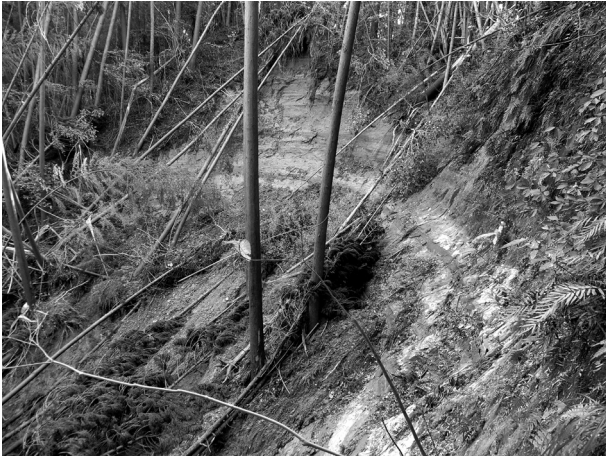
写真6 平成30年台風第24号の被害で剥き出しになった佐土原城跡の岩盤斜面
