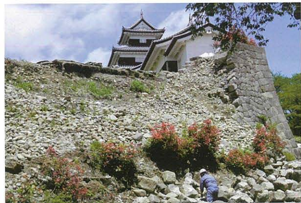
小峰城跡の石垣崩落状況
