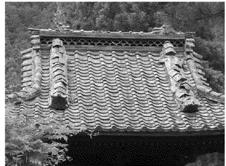
修理前 (北面屋根)
