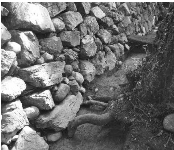
Fig.48 西面埋もれ隅角
