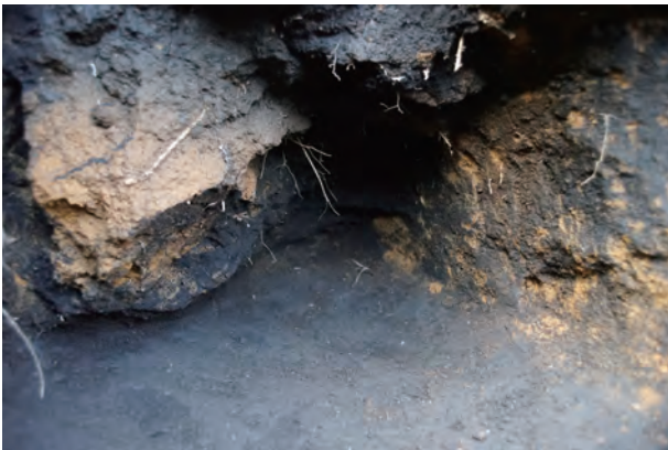
玄室右側天井陥没状況（東から）
