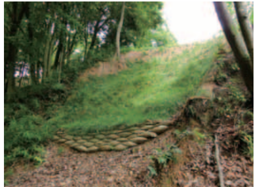
④南B地区：崩れた斜面（養生済）
