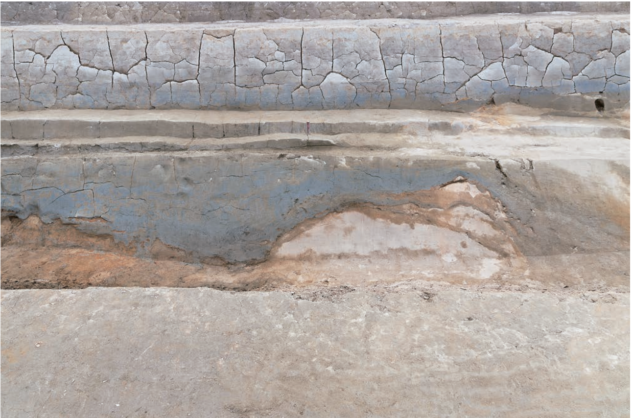
(2) 地震痕跡近景(東から)
