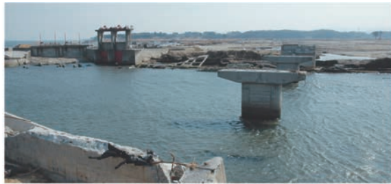
写真2 東日本大震災被害状況(2) (原町区小浜付近)
