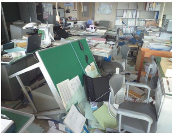
写真7 東日本大震災被害状況（7）
