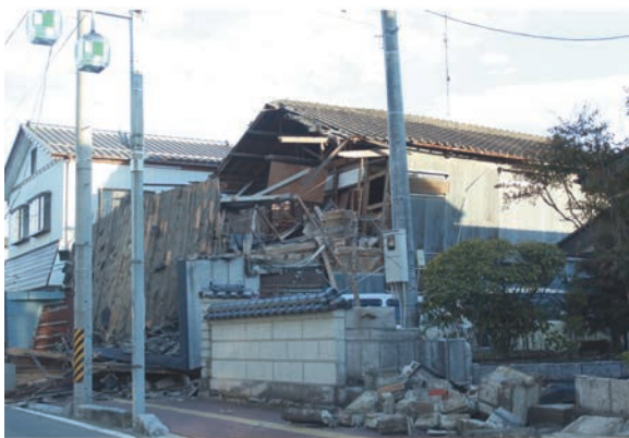
写真5 東日本大震災被害状況（5）
