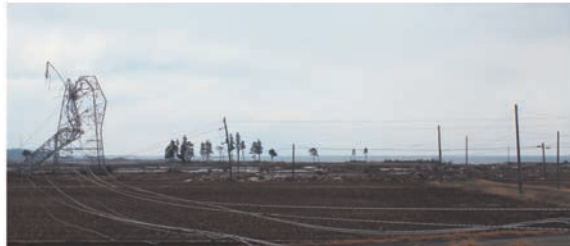
写真3 東日本大震災被害状況(3) (原町区鞆付近)
