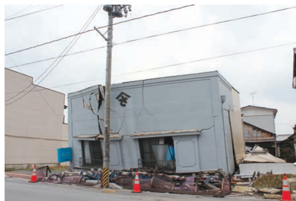
写真12 東日本大震災被害状況 (12)
