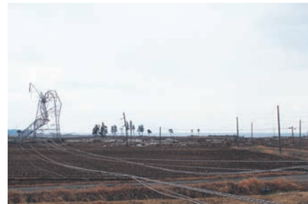
写真3 東日本大震災被害状況 (3)
