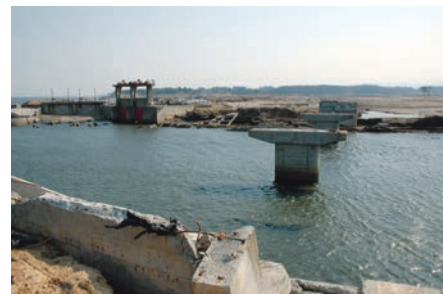
写真2 東日本大震災被害状況 (2)
