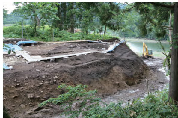
5 第I層除去後 東→ (旧村道(攪乱)の法面に現れた捨場堆積層)
