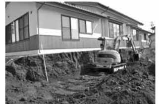
擁壁箇所堆積状況
