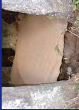
▲震災直後（平成23年3月17日撮影）
