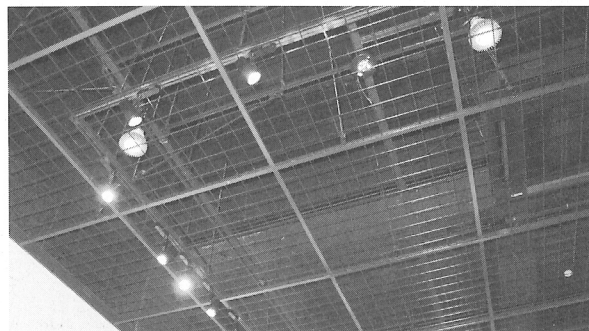
LEDライトの設置状況（企画展示室）
