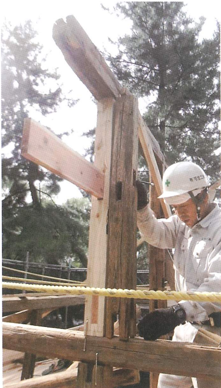
棟束（北側を交換） 写真右側の既存材は断面欠損 が大きかったため処分するこ ととした
