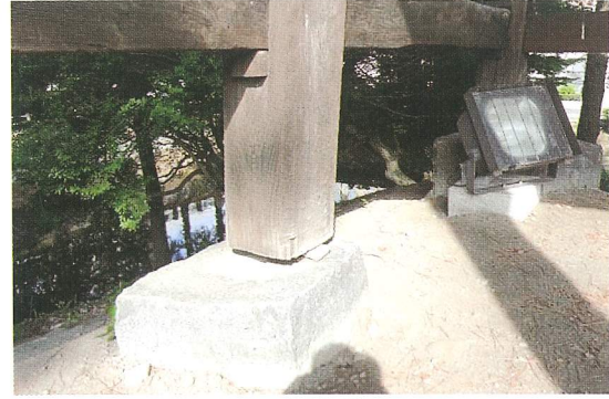
北側中柱 礎石の移動により柱が浮いている状態 ホゾは腐って滅失している。
