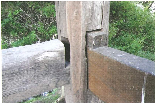
柱と貫 架構の動きにより貫が外れ、楔は用をなしていない。
