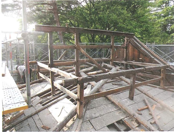
既存小屋組 木組みに関係のないホゾ穴が多く、転用材が使われたと思われる。
