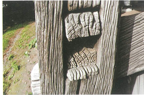
柱と貫接合部 経年劣化が激しい。
