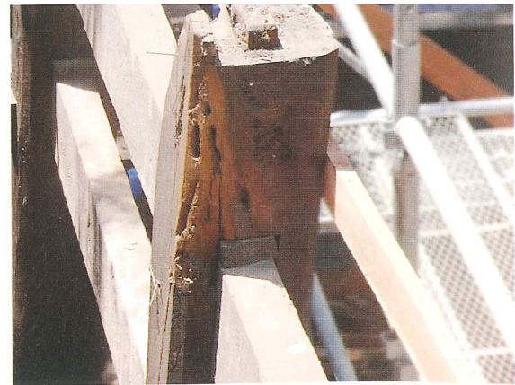
桁撤去後（柱の状況） 上部に腐れ、虫害が見られる。
