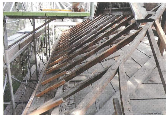
妻側（垂木の状況） 軒先の垂木が切断され補助垂木により折 り上げされている。
