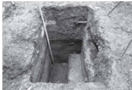
D. 札幌キャンパス避難施設水槽設置その他工事 TP06 西壁 1515
