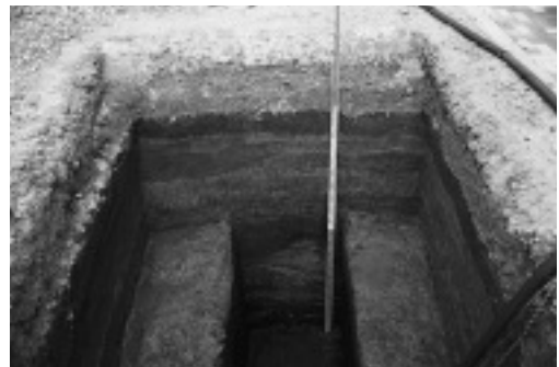
D. シオノギ共同研究棟 (創薬基盤技術研究棟) 建設に伴う設備工事予定地 TP 01 東壁 0709
