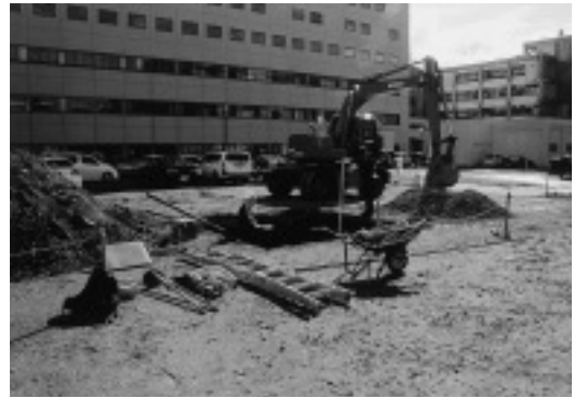
B. 病院給食調理施設新営等増改修工事予定地 TP 07 調査状況 (東より) 0618
