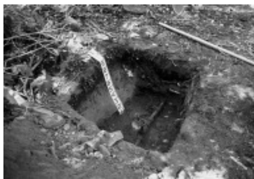
P. 植物園エンレイソウ園水抜栓取替工事掘削状況 (北より) 0615
