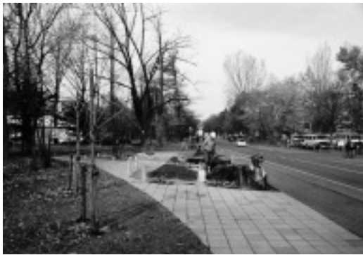
K. 構内（中央道路）外灯増設工事予定地 TP 03 調査状況（南より）
