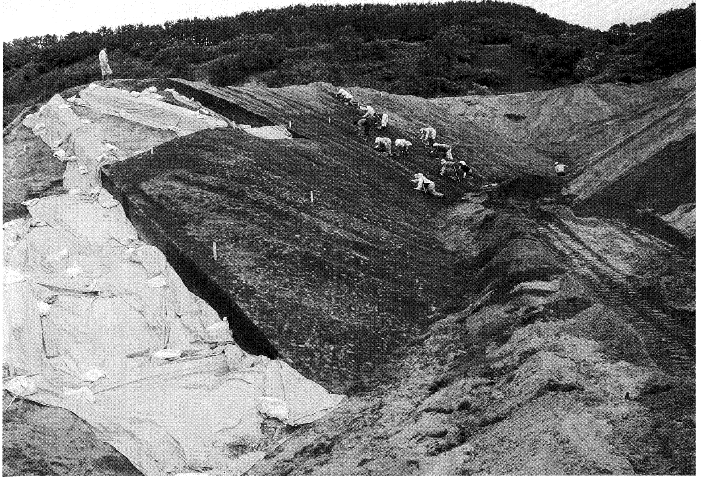
畠跡の傾斜①（南から）
