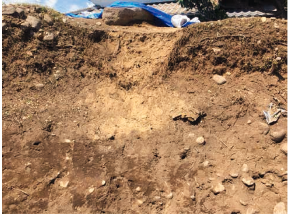
写真16 相原廃寺基壇崩落箇所
