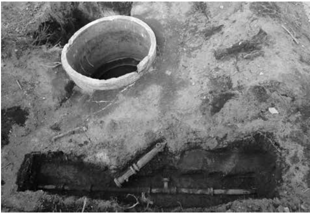
火工廠 水溜 8・消火栓 2
