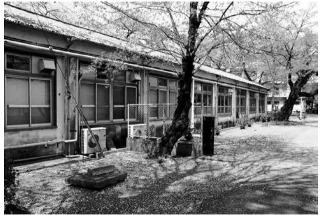
2 南東面 窓はアルミサッシュに 改造されている
