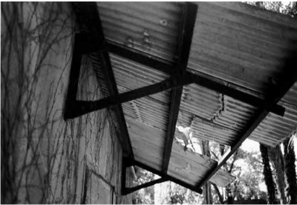
11 入口上部の屋根吹き下ろしの庇 葺き材は波形ストレート
