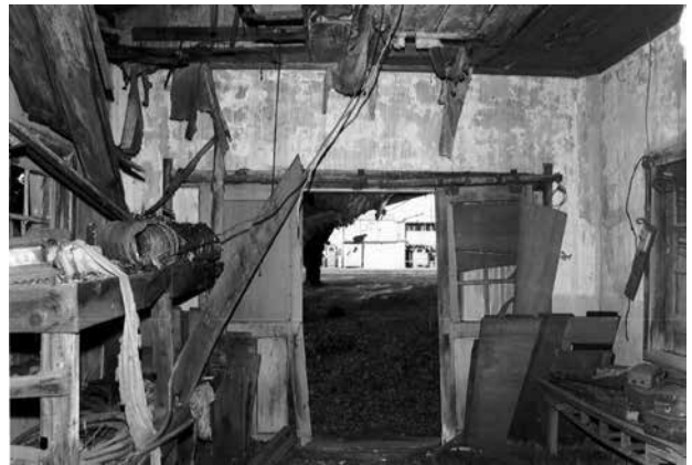
18 南西妻側を見る 入口にハンガードアが残る
