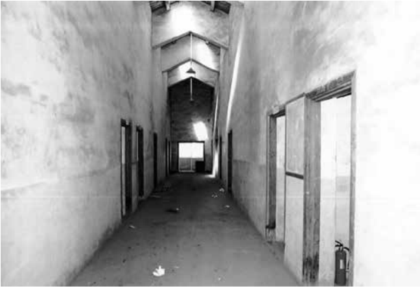
9 内部中廊下 コンクリート製の登り梁がむき出しの状態
