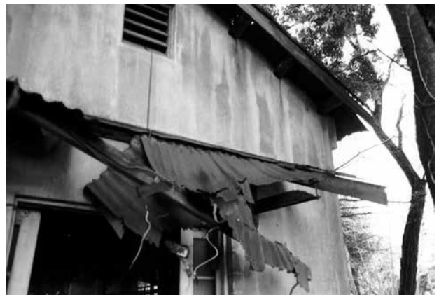
14 庇の破損状況写真
