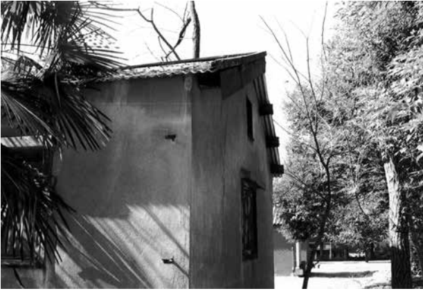
9 破風板、雨樋の消失
