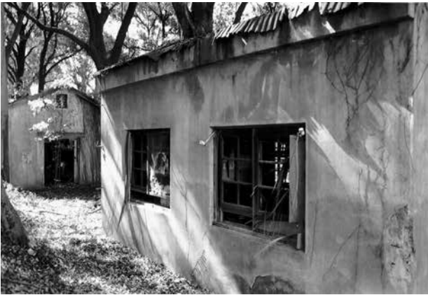
11 南東面 かなり枯葉に埋もれている
