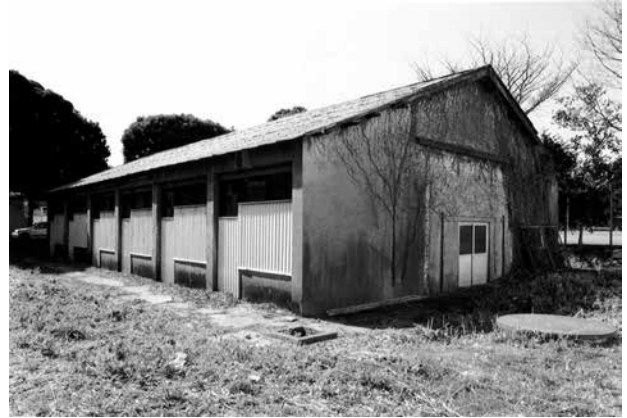
4 東側から見た全景 風除室は失われ、破風板も損傷している 木製窓は金属製パネルで覆われている
