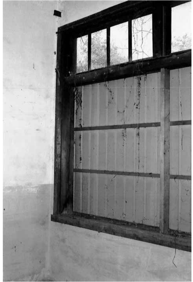
16 窓は引き違い 建具は消失
