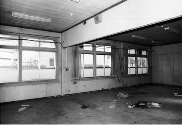
31 同 29 南東の窓側を見る 床、天井とも創建時の板張りが残る
