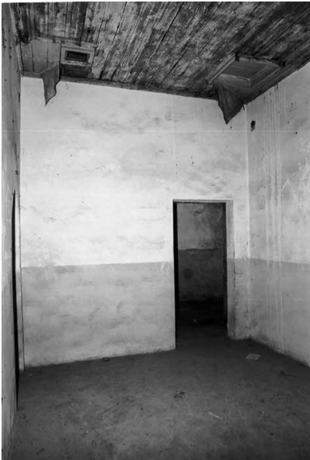
21 作業室窓側から廊下側を見る 天井の高さは約3.5mと高い
