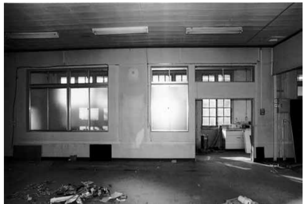
29 25 とはまた別の作業室 右手の下り壁は後世の改造による
