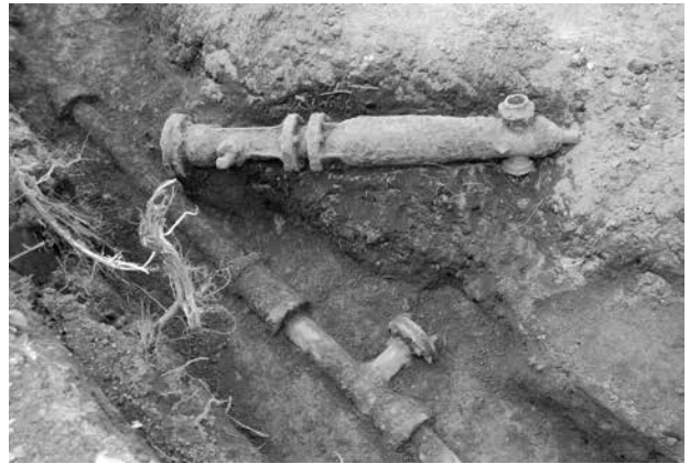
火工廠 消火栓 2
