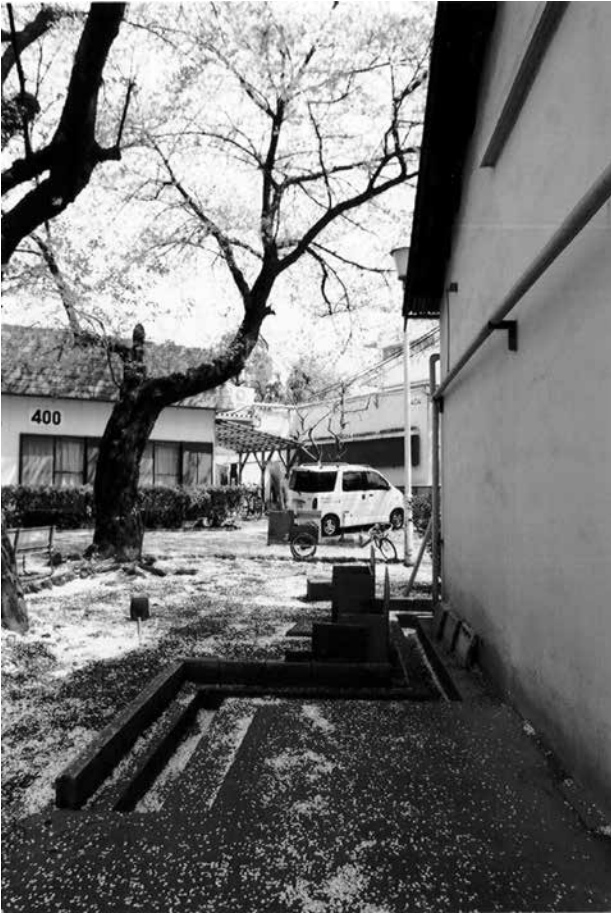
7 東北面妻側の雨水用の排水路は風除室があったことを示している
