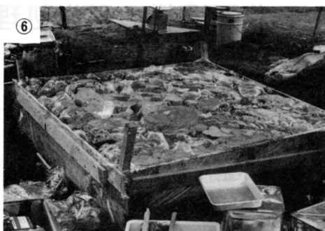
⑥ 表面に発泡ウレタン樹脂を流し込み、さらに頑丈に固定する。発泡ウレタンの節約のため、ビニール袋等で風船をつくり、つめる。発泡が始まったら板等で圧力をかけ平らにする。 薬剤：ハイブックス（主剤・硬化剤）主剤対硬化剤＝1対1
