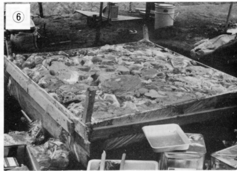
6 表面に発泡ウレタン樹脂を流し込み、さらに頑丈に固定する。発泡ウレタンの節約のため、ビニール袋等で風船をつくり、つめる。発泡が始まったら板等で圧力をかけ平らにする。 薬剤：ハイブックス（主剤・硬化剤）主剤対硬化剤＝1対1
