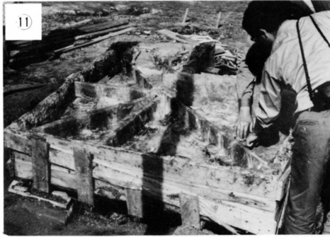
裏に支えの骨組をつくり、裏土と一体化させるため、ポリマールをしみ込ませたグラスファイバーマットをはりつける。
