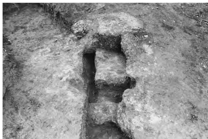
2号墳石室天井石崩落状況
