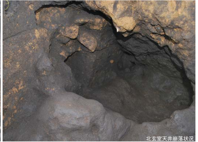
北玄室天井崩落状况
