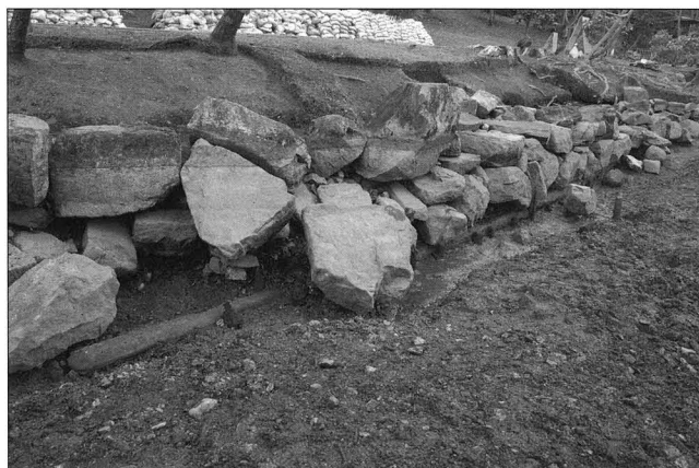
春風埜東側の護岸 江戸時代に改修された石積み護岸。胴木が ずれないように杭が要所に打たれている。
