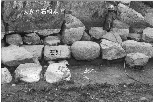
春風埜東側の護岸（詳細） 大きな石組みや築山が造成される箇所には、 石列の下にも胴木を置いて補強している。
