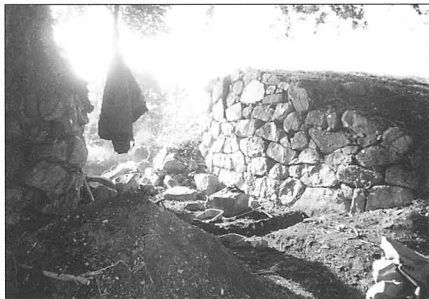
写真9 修理前(米蔵水門石垣第6面)
