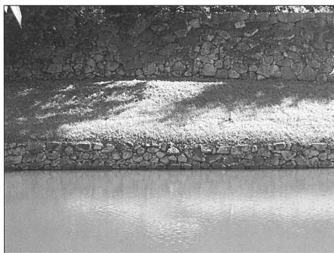
写真89 修理前（内堀沿い修理石垣No.12）
