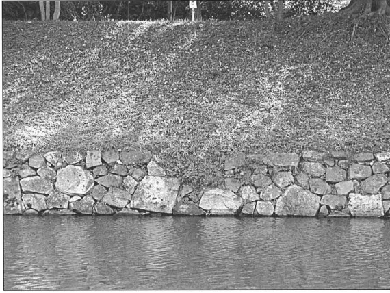
写真80 修理前（内堀沿い修理石垣No.8）
