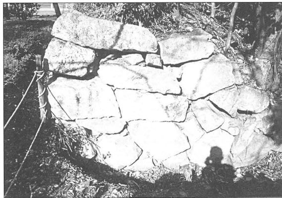
写真43 修理前（第2面南側）
