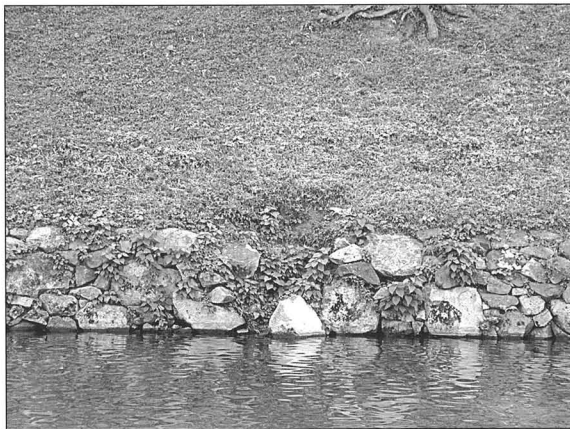
写真82 修理前（内堀沿い修理石垣No.9）
