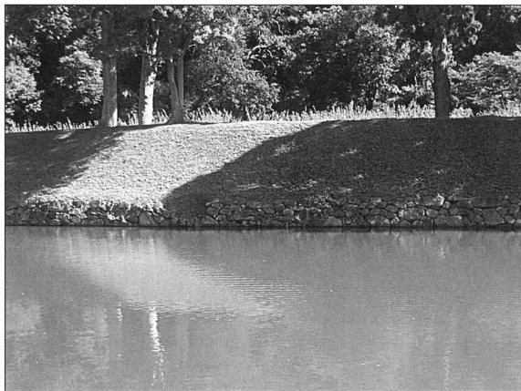
写真83 修理前 (内堀沿い修理石垣No.14)
