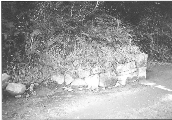
写真29 修理前 (御門石垣第1面)
