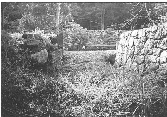
写真56 修理前（背面から撮影）
