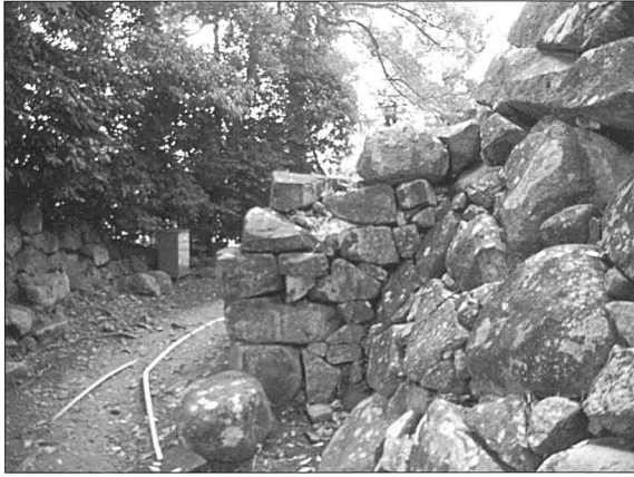
写真126 修理前 (石垣No.18-1)
