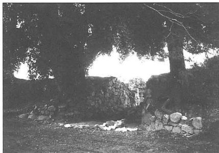
写真11 修理前(米蔵水門石垣第5面)
