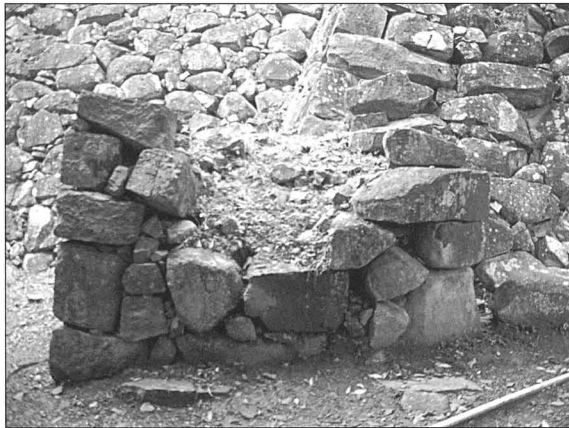
写真128 修理前 (石垣No.18)
