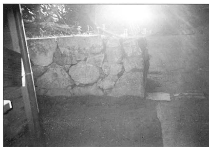
写真25 修理前(御門石垣第4面)
