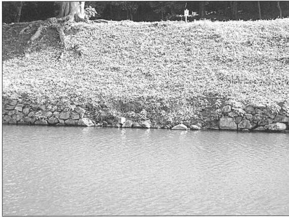
写真76 修理前（内堀沿い修理石垣No. 6）
