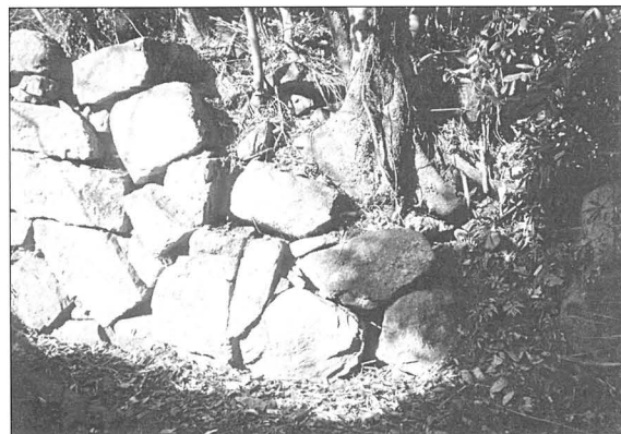
写真45 修理前（第2面中央付近）
