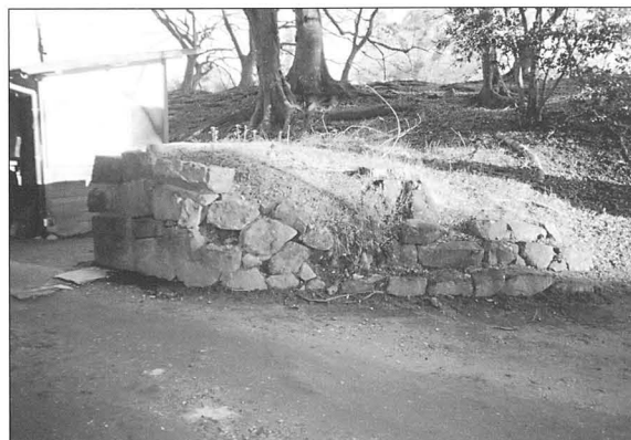
写真33 修理前 (御門石垣第3面)
