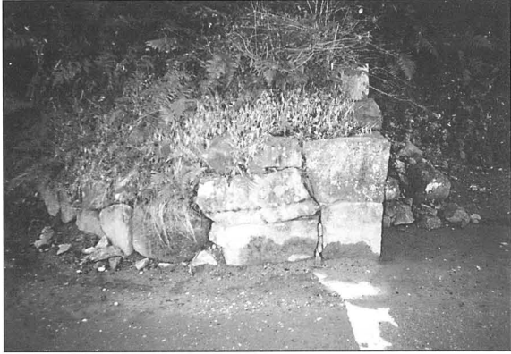
写真27 修理前 (御門石垣第1面)
