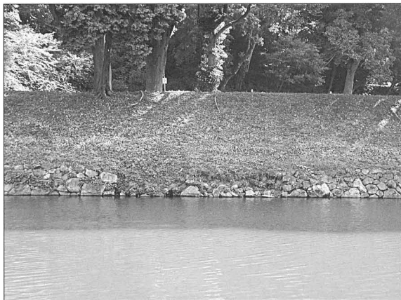
写真78 修理前（内堀沿い修理石垣No. 7）
