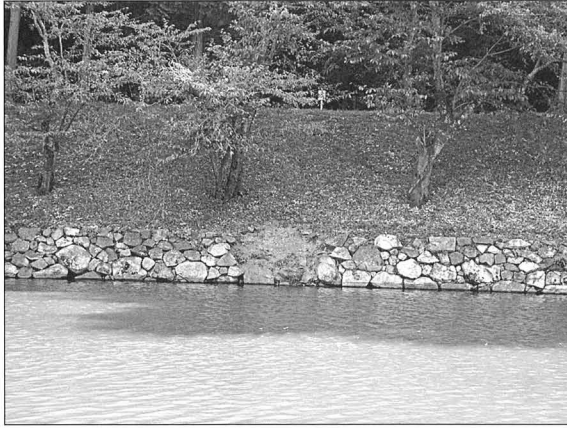
写真84 修理前（内堀沿い修理石垣No.10）
