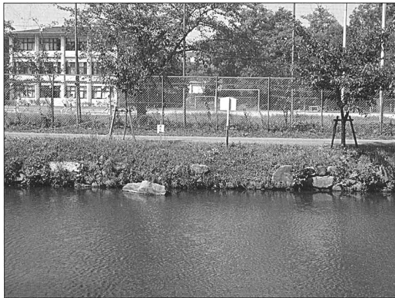
写真86 修理前（内堀沿い修理石垣No.11）
