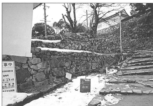
写真64 修理前（東から撮影）
