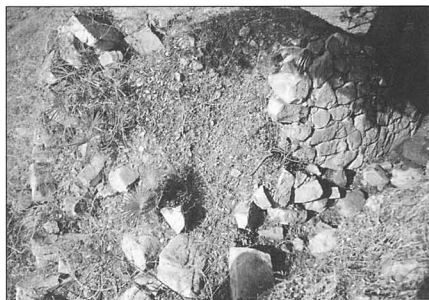
写真13 修理前(米蔵水門石垣第2・6面)
