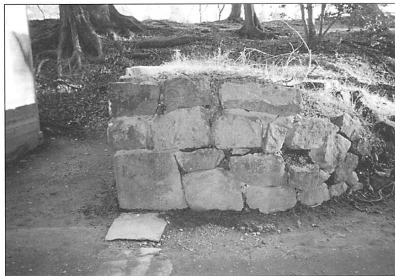
写真31 修理前 (御門石垣第3面)
