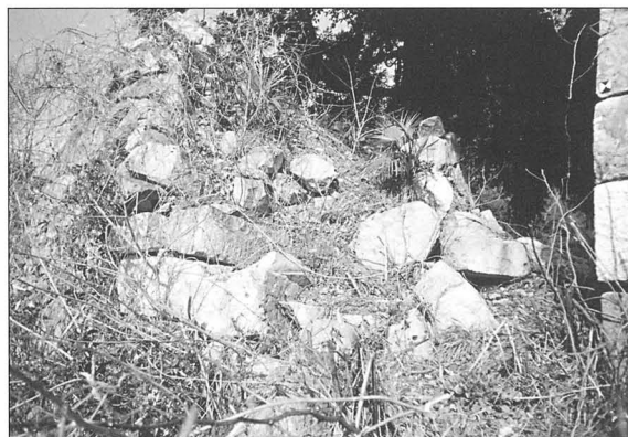
写真21 修理前 (米蔵水門石垣第2・6面)
