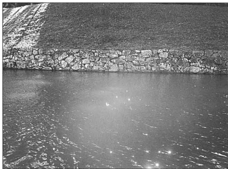
写真70 修理前（内堀沿い修理石垣No.3）
