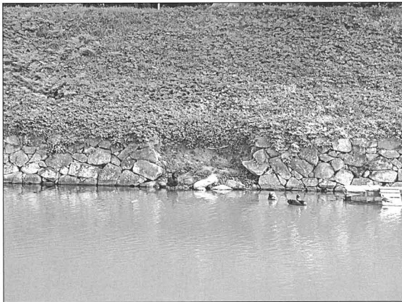
写真74 修理前（内堀沿い修理石垣No. 5）
